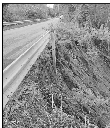
La strada chiusa a seguito dello smottamento
